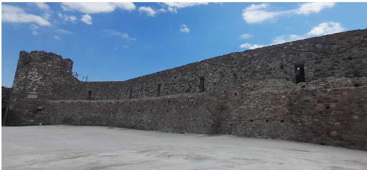
Εικόνα 2: Βόρειο τείχος Αποθηκών Σαπλιτζά, ως τμήμα του συνολικού επιθαλάσσιου τείχους με τη σημερινή του εικόνα. Διακρίνεται το κατώτερο τμήμα του τείχους που συμπεριφέρεται ως βάση για την στερέωση του ανώτερου και λεπτότερου τμήματος του τείχους.
